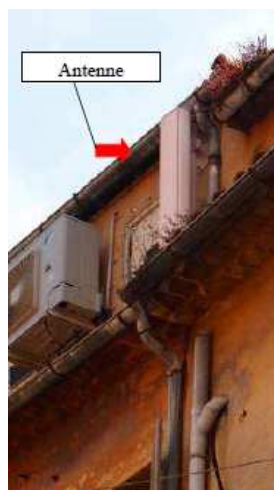
Figure 27 : antenne sur le mur en face de la terrasse PPE 3 - Cannes
